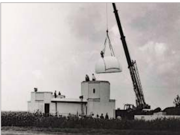
20 augustus 1988 – de grote koepel wordt op de toren gezet. De sterrenwacht nadert zijn voltooiing.
